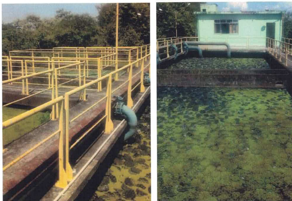
Figuras 39 e 40 – Tanques de Tratamentos da ETE Barrinha
