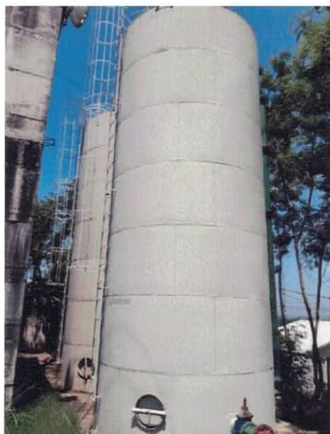
Figura 30 – Reservatórios cilíndricos inaugurados em 2015
