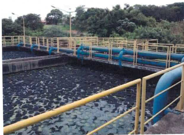
Figura 41 – Tanque de Aeração da ETE Barrinha
