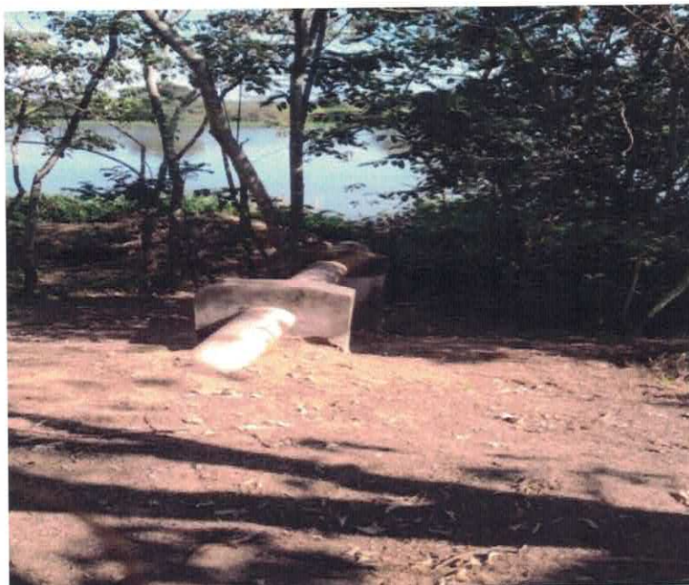
Figura 44 – Saída do Esgoto Tratado
