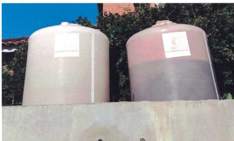
Figura 27 – Tanques de Armazenamento dos Insumos de Tratamento
