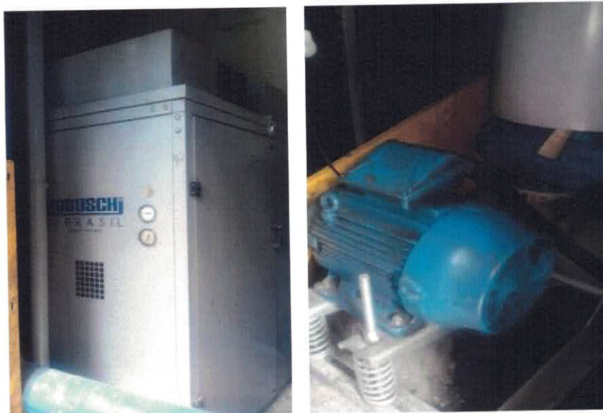
Figuras 42 e 43 – Cabine Acústica e Compressor
